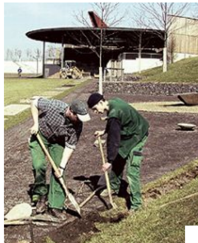
Letzte Vorbereitungen vor der Wiederoöffnung von Teilen des LGS-Geländes: Michael Willems Alexander Reis und Sabrina Winnebeck (v. l.), Mitarbeiter einer Trierer Gartenbaufirma, bei Erdarbeiten für eine Versickerungsmulde im Sattelpark unterhalb ...
